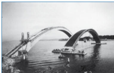
Le pont Albert Louppe. En haut : clouage du deuxième cours de volige en planches de 4 cm. En bas : la première arche terminée, le cintre quitte son premier emplacement par flottage pour se mettre en position de recevoir l'arche centrale (B. Marrey, Les ponts modernes, 20 e siècle , p. 58).
