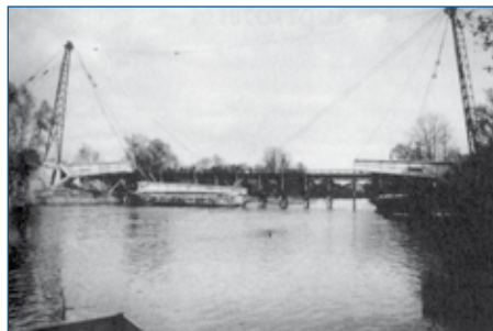
Mise en place de l'élément intermédiaire, au moyen de câbles supportés par des mâts en bois (E. Freyssinet, Un amour sans limite , p. 81).
